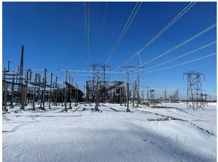
b) 161kV Power Line
