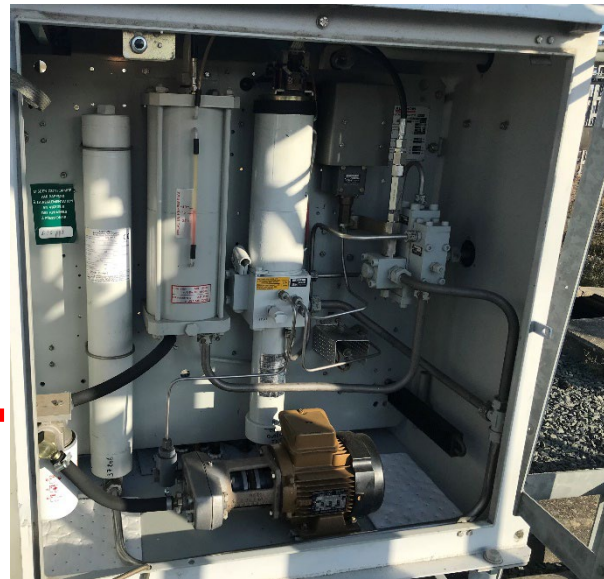
Ormar hidrauličnih komandi
